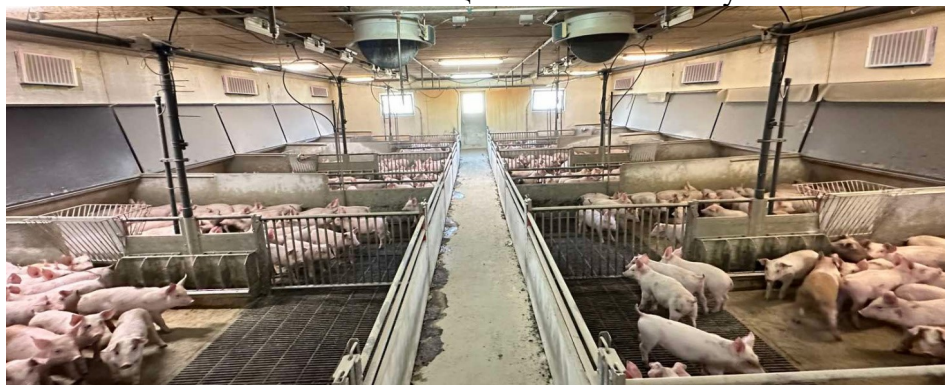
Стельова система вентиляції
